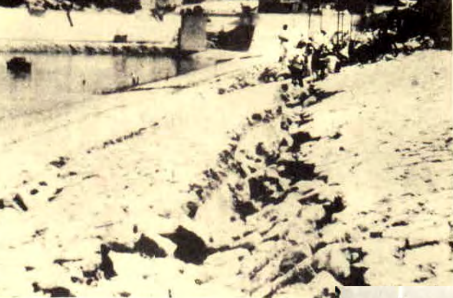
II-4-11 唐山陡河水库坝体纵向开裂
